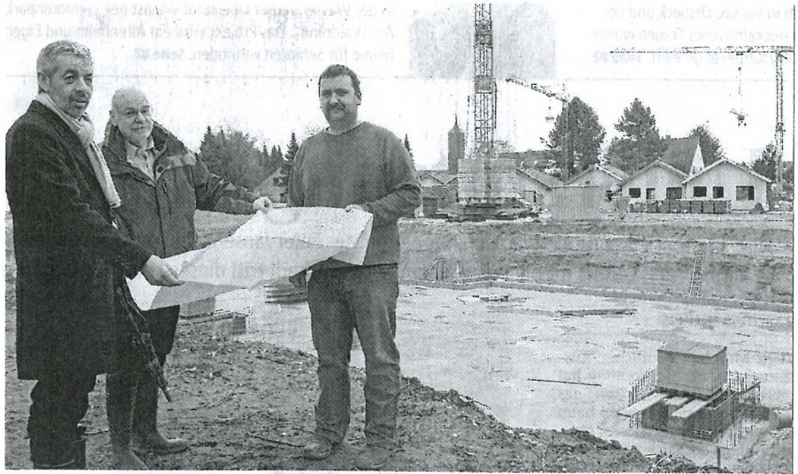
Zünftig voran gehen die Arbeiten für den Seniorenwohnpark Am Waldrand. Darüber freuen sich die Investoren Kurt Willems und Werner Jans mit Planer Josef Houben (v.r.).
